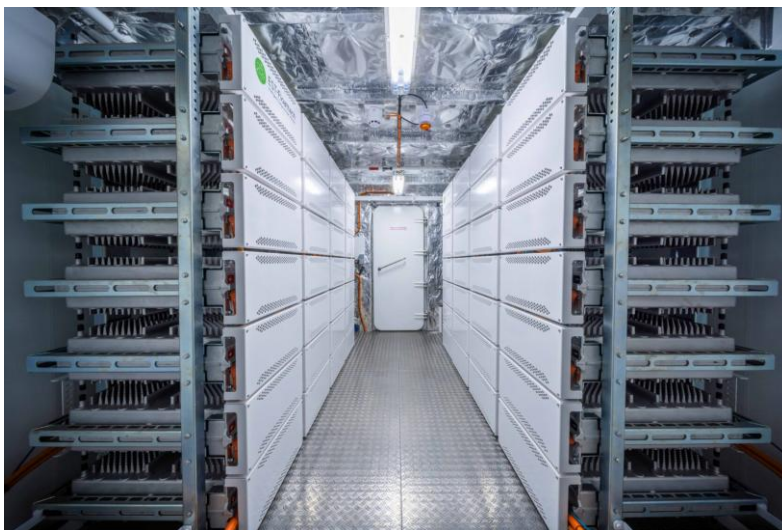
Foto: typische batterijruimte in een schip met Octopus-Series High Energy systeem uit 2024
